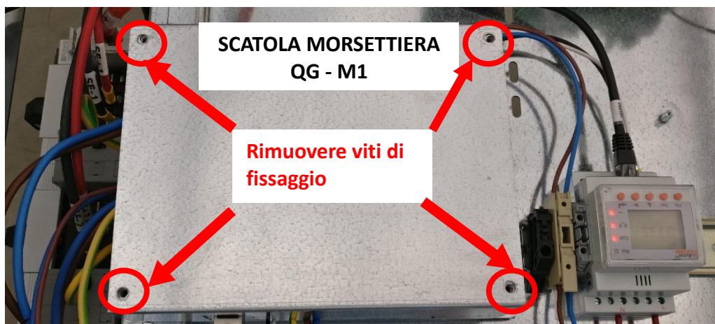
Figura 23 - Rimozione coperchio scatola morsettiera QG - M1
