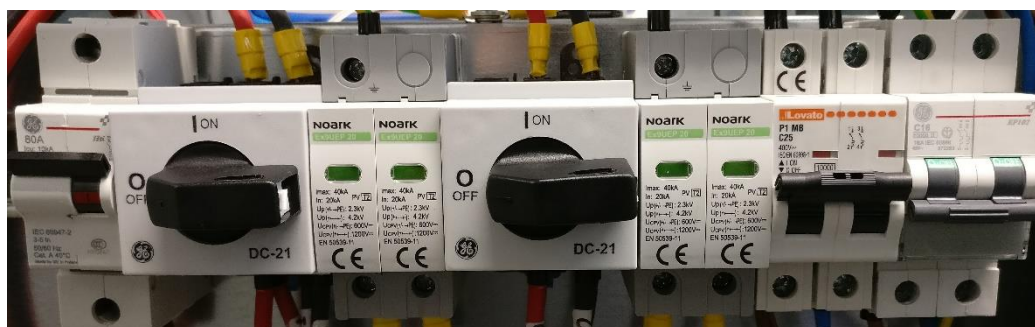
Figura 35 - Tutti gli interruttori del quadro elettrico in posizione di "ON"
