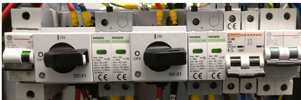
Posizione di partenza protezioni quadro elettrico RA.Store-K-F
