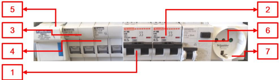
Figura 3 - Frontale quadro elettrico
