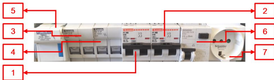
Figura 22 - Frontale quadro elettrico
