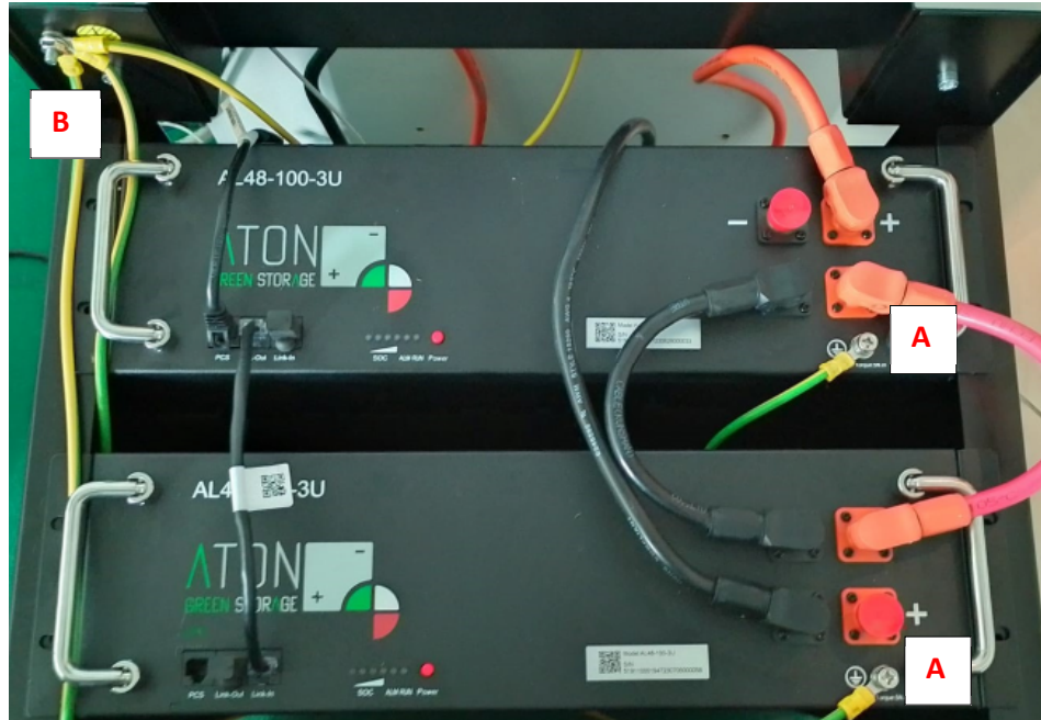
Figura 43 – Collegamento equipotenziale batterie Aton
