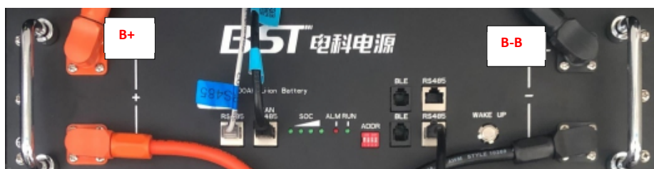
Figura 33 – Collegamento cavi alimentazione delle batterie BST dall’inverter
