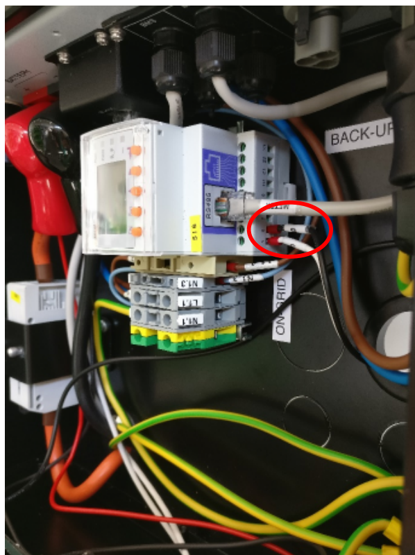
Figura 69 - Collegamento dei 2 cavi del sensore CT sul Meter Acrel
