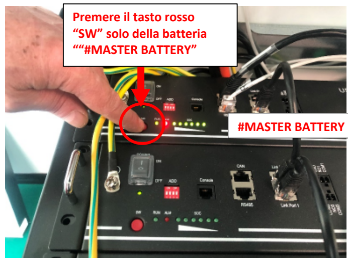
Figura 79 - Accensione batterie Pylontech
