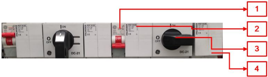
Figura 3 - Frontale quadro elettrico per modello due stringhe
