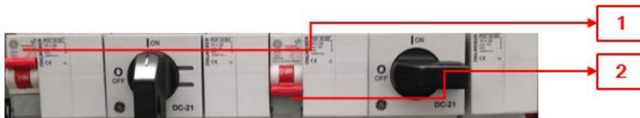
Figura 12 - Frontale quadro elettrico
