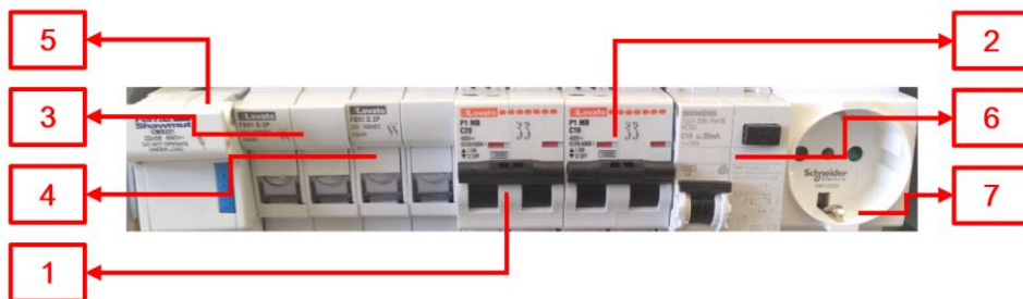
Figura 2 - Frontale quadro elettrico
