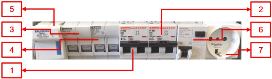
Figura 11 - Frontale quadro elettrico
