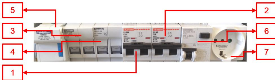
Figura 2 - Frontale quadro elettrico
