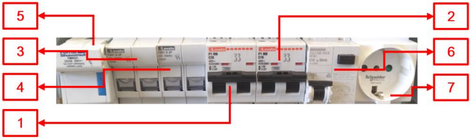
Figura 11 - Frontale quadro elettrico
